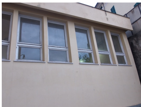
Figura 8.1 - Particolare serramenti da sostituire.
