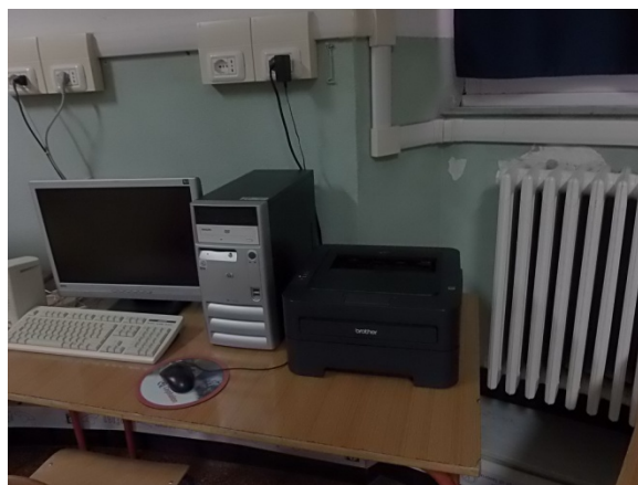
Figura 4.6 – Particolari del sottosistema di emissione: un radiatore posto all’interno di un ufficio
