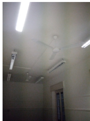
Figura 8.13 - Particolare impianto illuminazione su cui intervenire.
